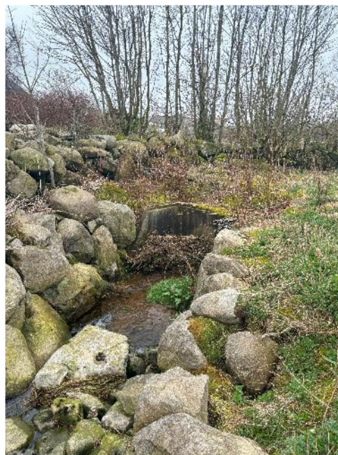
Inntak til bekkeløp på eiendom 79/9. Rørdimensjon 800 mm med tildekket rist foran.
