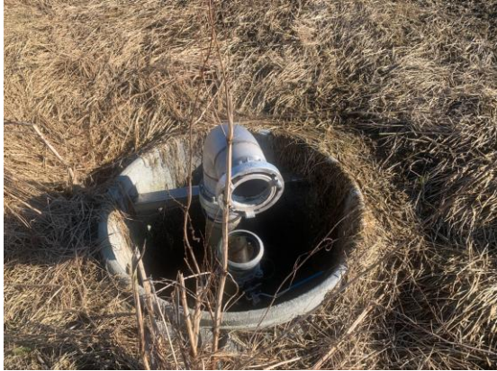
Figur 15: Gjødseluttak på eiendom 77/105 (foto: Hå kommune, 2023)
