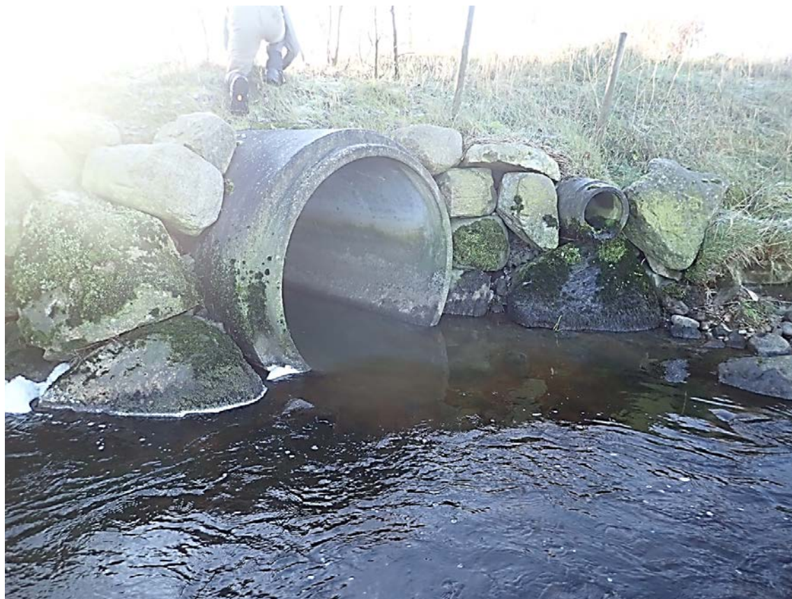
Figur 9: Utslippspunkt i Sone S16. Vannet som kom ut av røret hadde grå farge og det kunne se ut til å inneholde suspenderte finsedimenter.
