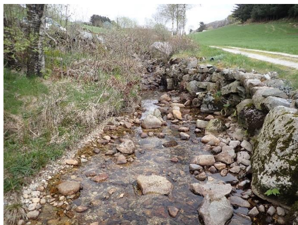
Figur 15. Manglende kantvegetasjon og forbygning i segment L1.
