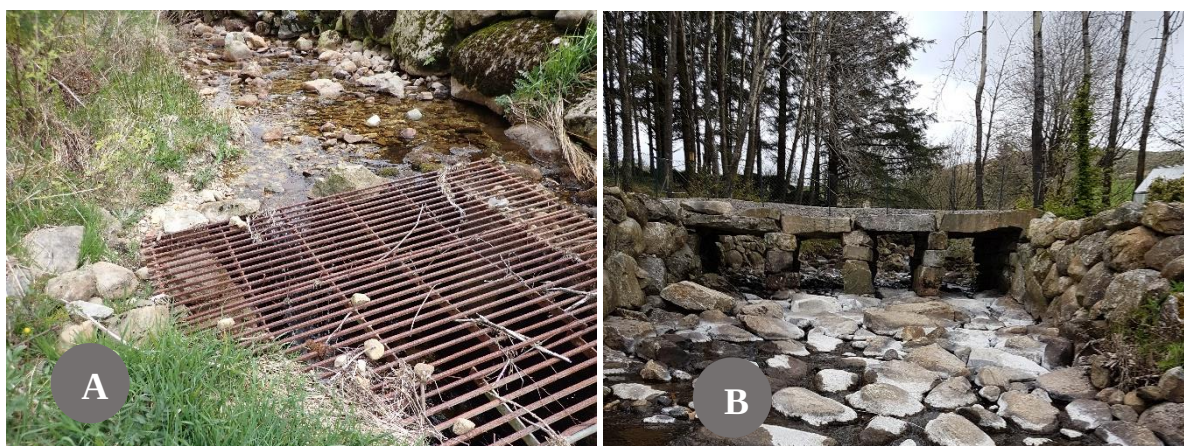
Figur 10. A) Inntaket i bekken fra Lasseskardet går gjennom rist og det er et fall på 2 meter fra risten og ned til bunnen. B) Ny bro i segment 6 ved Nordre Hetland. Det er plastret i bunnen i tilknytning til broen og det er vanskelig å passere ved lav vannføring.
