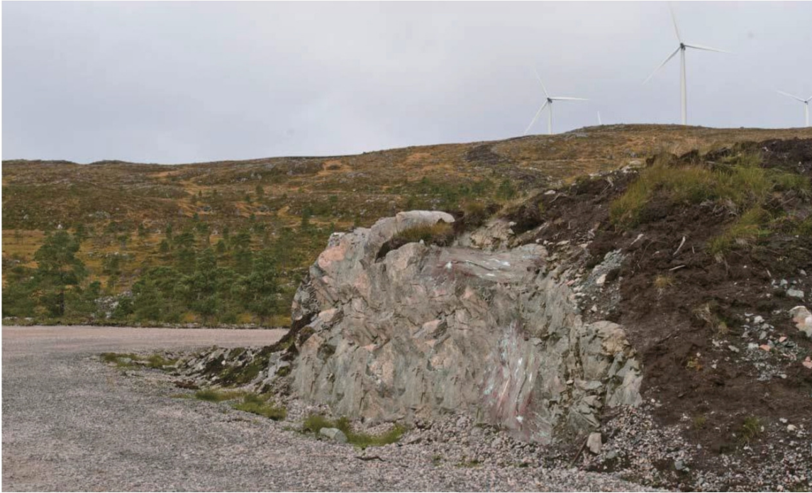
Figur 7 – Fjellskjæring uten tiltak (kilde: Norconsult)
