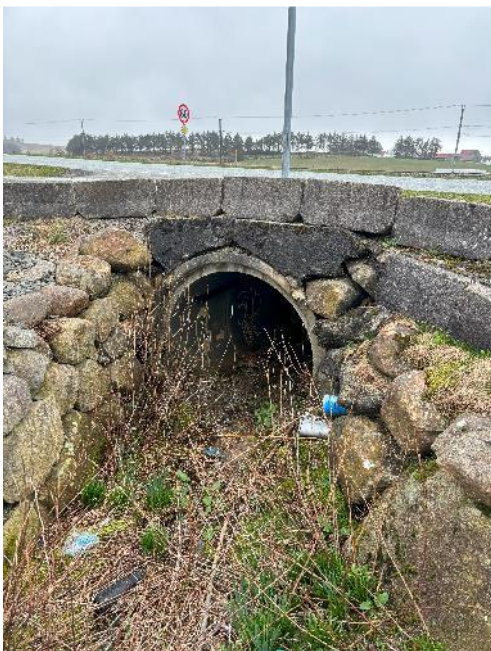
Kulvert under Haugstadvegen, dimensjon 1800 mm.
