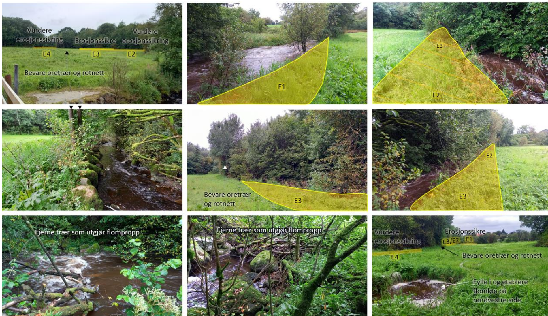
Figur 4. Tiltaksområde T-RI3. Områder som bør erosjonssikres er markert med gult. Bildene viser bekkeløpet fra øvre deler og ned til enden av dyrkamarka.
