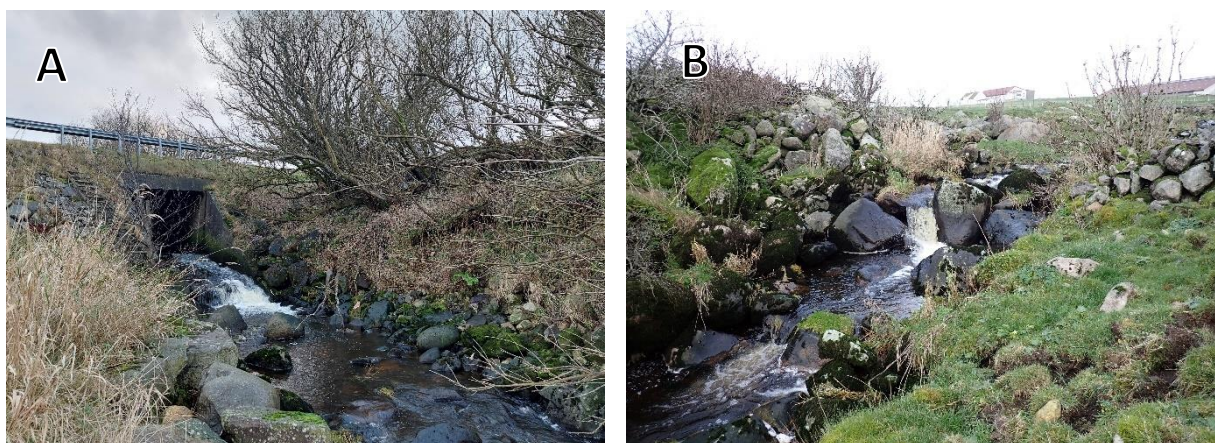
Figur 18. Vandringshindre og bekkelukkinger: A) Kunstig temporært vandringshinder i forbindelse med kulvert under Nordsjøvegen (Fv44) i segment 2. B) Blokkstein danner fall som er krevende å passere i øvre del av elven (segment 50).
