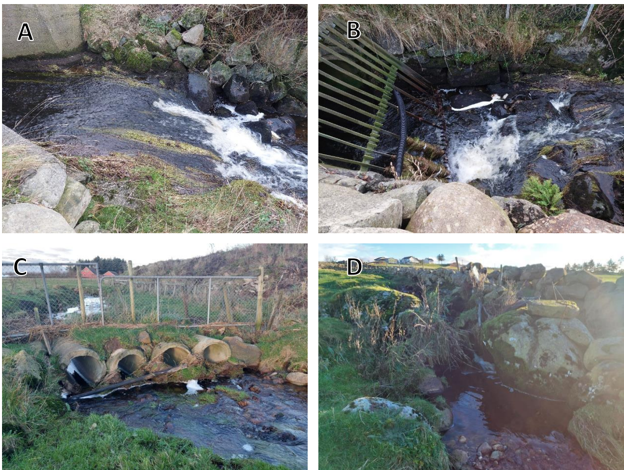
Figur 32. Vandringshindre og bekkelukkinger: A) Kunstig temporært vandringshinder i forbindelse med kulvert under Nordsjøvegen (Fv44) mellom segment 10 og 11. B) Utgangen av det lange røret nederst i segment 13. Røret er langt og blir noe brattere mot slutten, og blir enda brattere på det steinplastrete partiet like ovenfor røret. I sum danner dette mest sannsynlig et absolutt vandringshinder. C) Flere steder har det samlet seg masser foran rør som reduserer passeringsmulighetene for fisk, eksempelvis i segment 36. D) Større blokker i bekken utgjør et naturlig temporært vandringshinder i segment 39.
