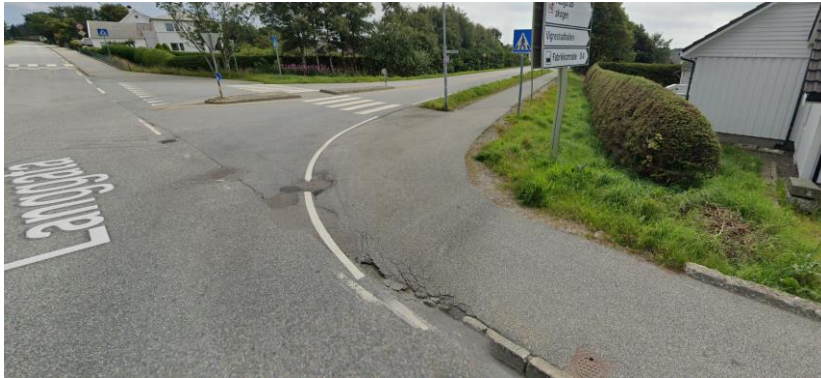
FIGUR 57 Google Street View (aug. 2022) fra Langgata vest mot Rundvegen. Manglende kantstein på fortauet.
