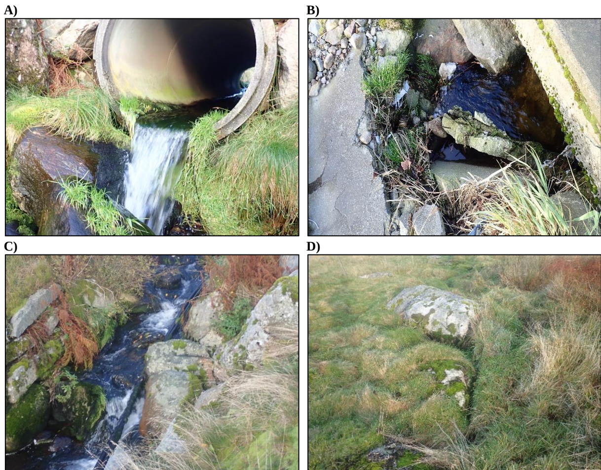
Figur 15.2. Vandringshindre og bekkelukninger i Veisedalsbekken: A) Røret i overgangen til segment 5 er forhøyet og utgjør et temporært vandringshinder. B) Betongkulverten i segment 8 har krevende passasje ettersom det er tilnærmet tettet igjen av drivved. C) Det nederste temporære vandringshinderet i segment 13 er en kunstig terskel like oppstrøms røret. D) Anadrom slutt der bekken blir for liten, øverst i sideløpet mot nordvest, i segment 16.
