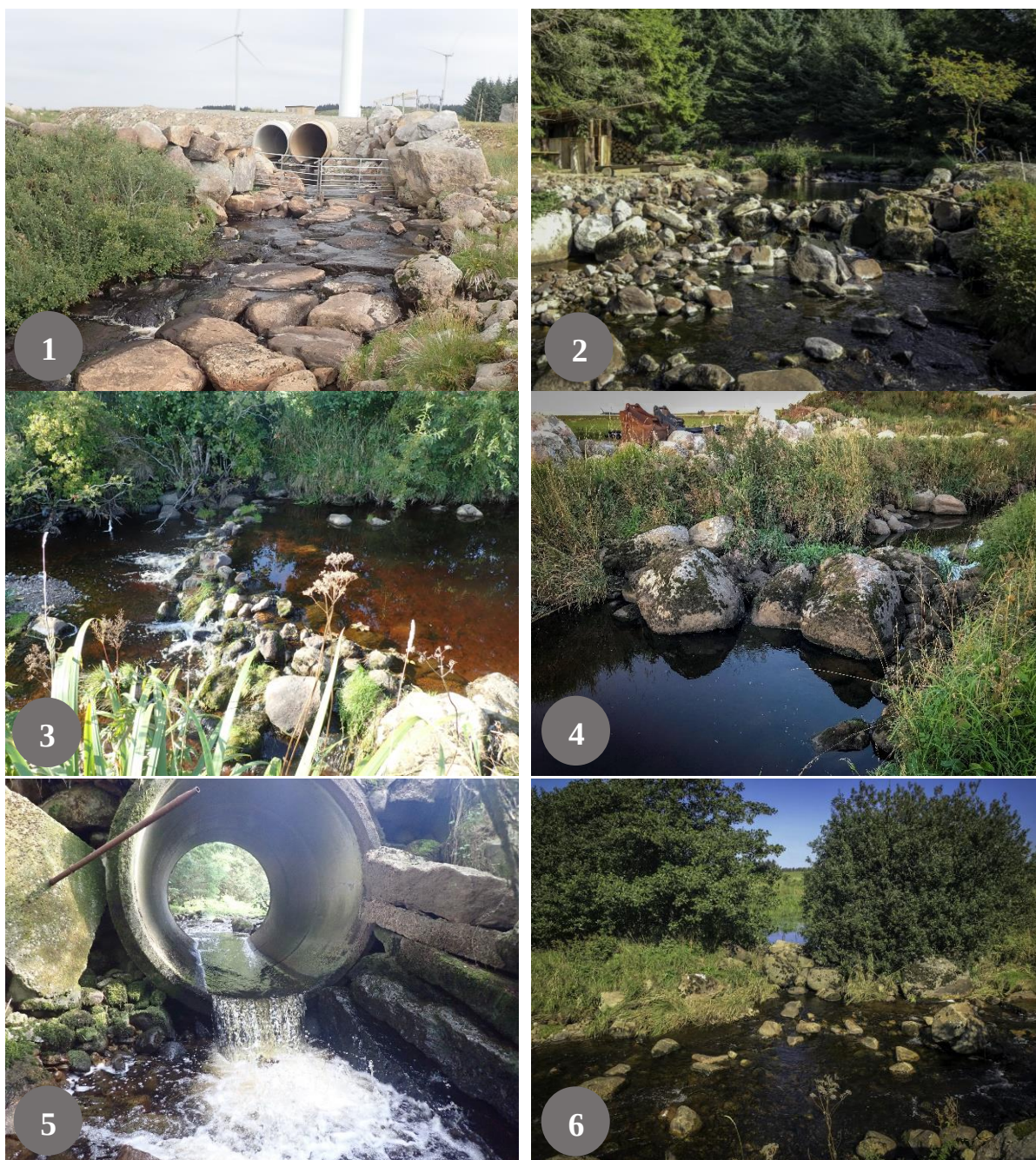
Figur 11. Bilder av vandringsbarrierer i Varhaugselvene tatt i perioden 3. – 5. september 2018. 1) Rør som kommer ut for høyt i forhold til elveløpet nedstrøms, i øvre del av Tvihaugbekken. 2 og 3) Kunstige terskler i Tvihaugbekken. Disse skaper oppholdsplasser for stor fisk, men er laget med en jevn høyde som gir mange små løp som ikke har nok vann til at fisk kan vandre forbi på lav vannføring. Det bør lages en hovedåpning i hver terskel som slipper gjennom det meste av vannet når vannføringen er liten. 4) Terskel i Rongjabekken. 5) Rør i Brattlandsåa. 6) Kunstig vandringshinder nederst i Opstadbekken.
